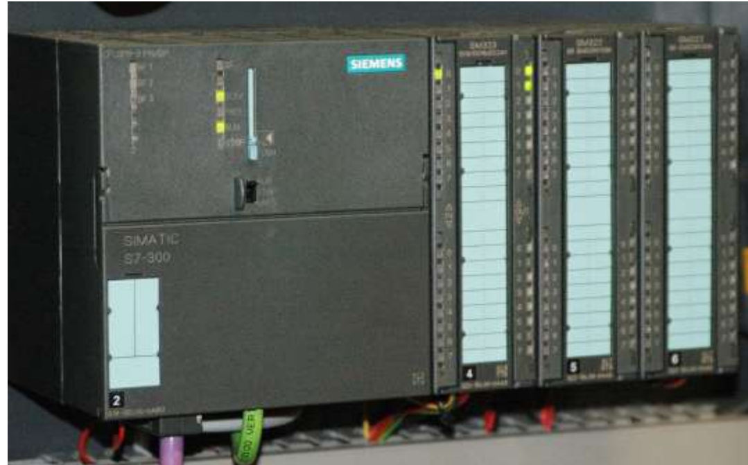
Siemens PLC CPU.
